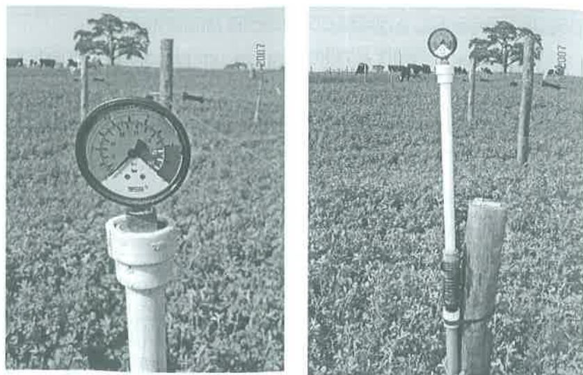
Figura 10: Manômetro adaptado para medir pressão no engate dos aspersores a - Manômetro e engate; b - detalhe do manômetro
